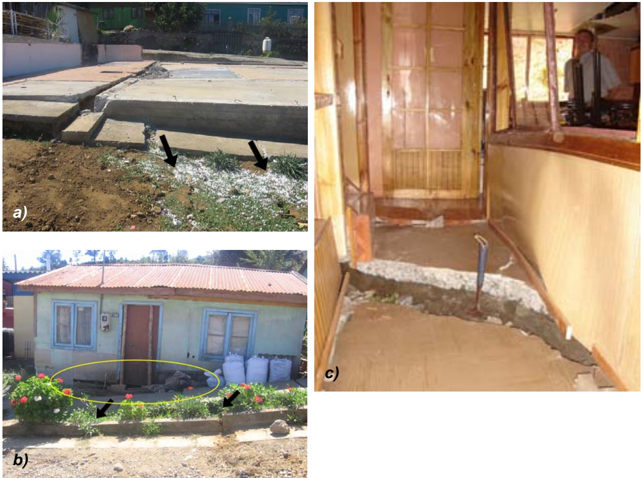
Figura 2: Fotografías que muestran los daños generados en las viviendas de la población El Colo, ciudad de Tomé, producto del agrietamiento y asentamiento del terreno de fundación. Nótese en todas las imágenes que existe un desplazamiento compuesto (vertical y horizontal) de las grietas en decenas de centímetros. La dirección de las grietas en a) (calle Llacolén #333) es N75^{\circ}E , en b) (calle La Merced) y c) (calle Henríquez) es de N20^{\circ}W .
