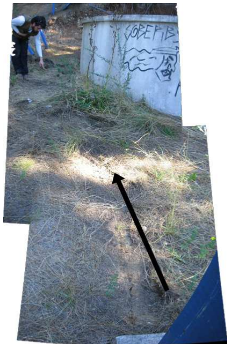
Figura 3: Fisura que pasa por un costado de la copa de agua ubicada al sur del camino de ingreso a Punta Lavapié. La copa no está comprometida por esta estructura.
