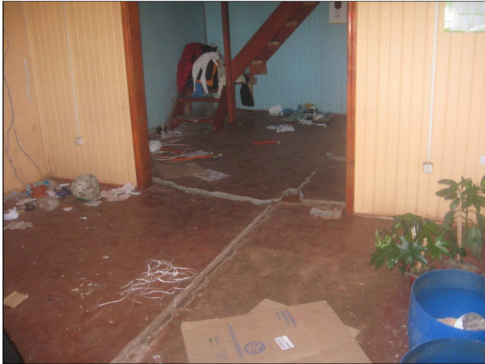
Figura 3: Grietas en pisos, al interior de vivienda.
