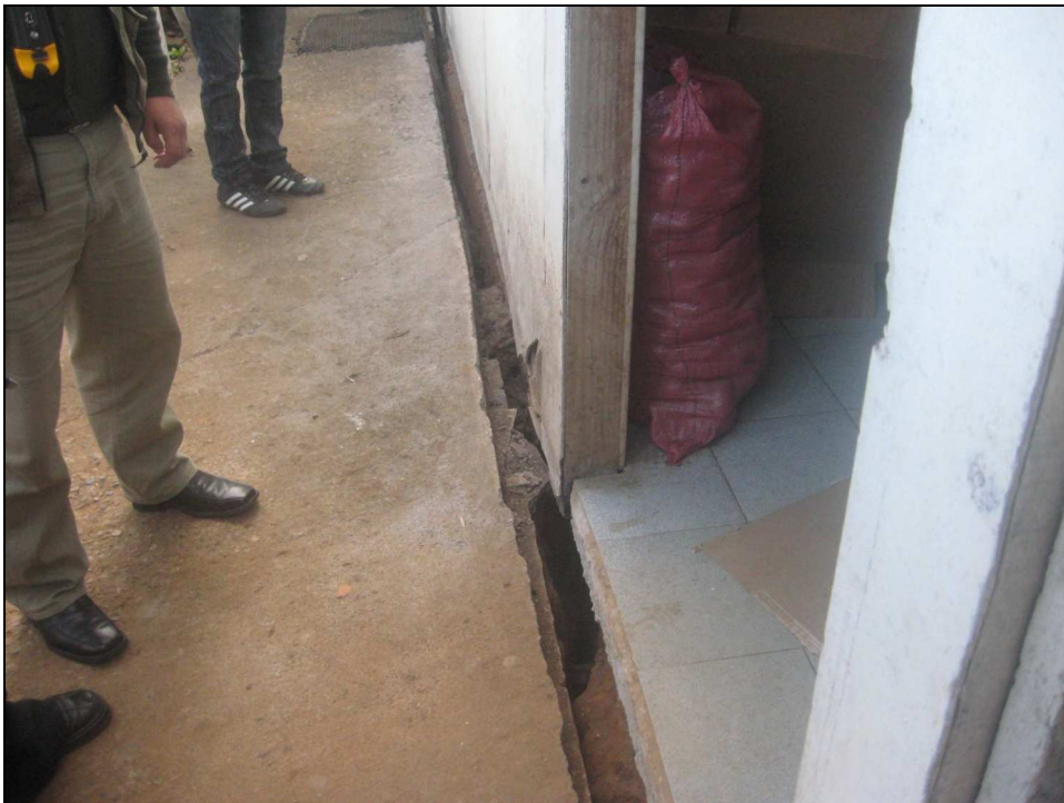
Figura 2: Muestra separación de pisos por movimiento diferencial y asentamiento del terreno.
