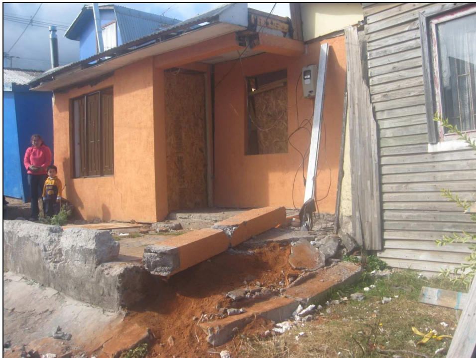
Figura 4: Colapso de suelos de fundación debido al asentamiento y subsidencia de terrenos.
