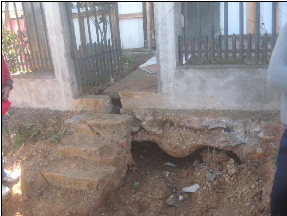
Figura 6: Profundas grietas, originaron el colapso de suelos de fundación de numerosas viviendas
