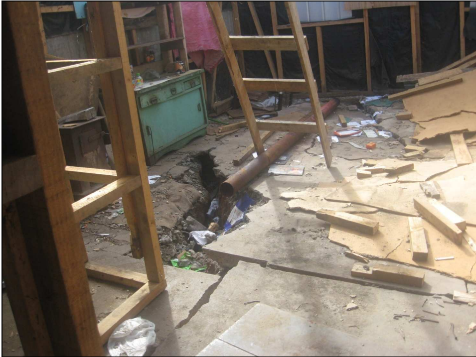
Figura 1: Se observan grietas de más de 10 cm de abertura en patio de vivienda.
