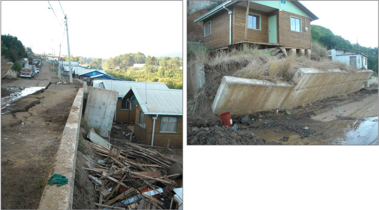
Figs. 6 y 7. Deformación de tipo deslizamiento compuesto a lo largo de la ladera ocupada por las calles Las Araucarias y Colo Colo en la Población Gajardo Sur.
