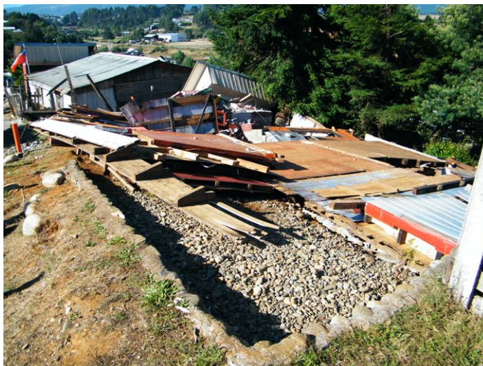
Fig. 11. Vivienda completamente destruida en la calle Inés de Suárez entre las casas #257 y #8, puesto que había sido construida en el borde del escarpe y sobre un relleno artificial de arcillas, el cual no fue capaz de sustentarla.
