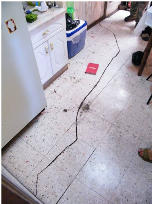
Fig. 9. Calle Séptimo de Línea casa #471 donde una grieta N140°E atravesaba el piso de la cocina
