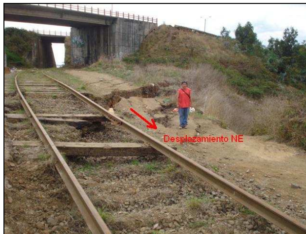
Figura 6. Vía férrea afectada por hundimientos y desplazamientos en el terreno, sector La Vega.
