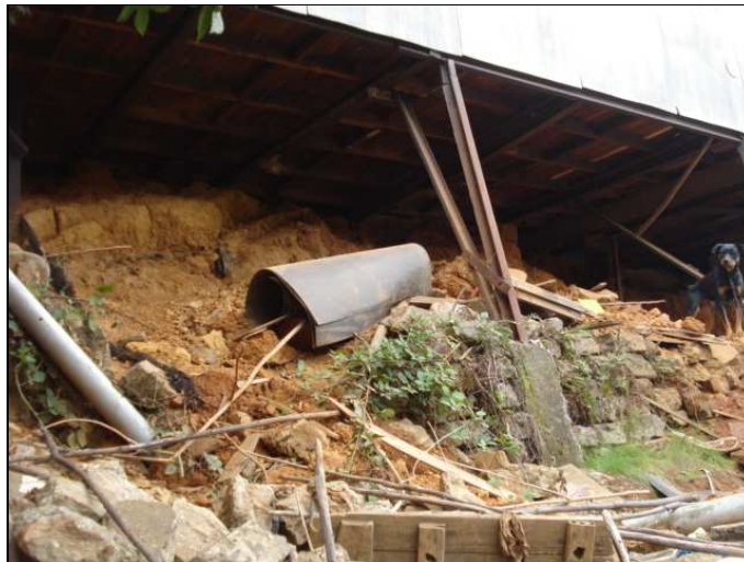
Figura 3. Casa con deslizamientos de suelo en su parte trasera, ubicada en el Pasaje 7.
