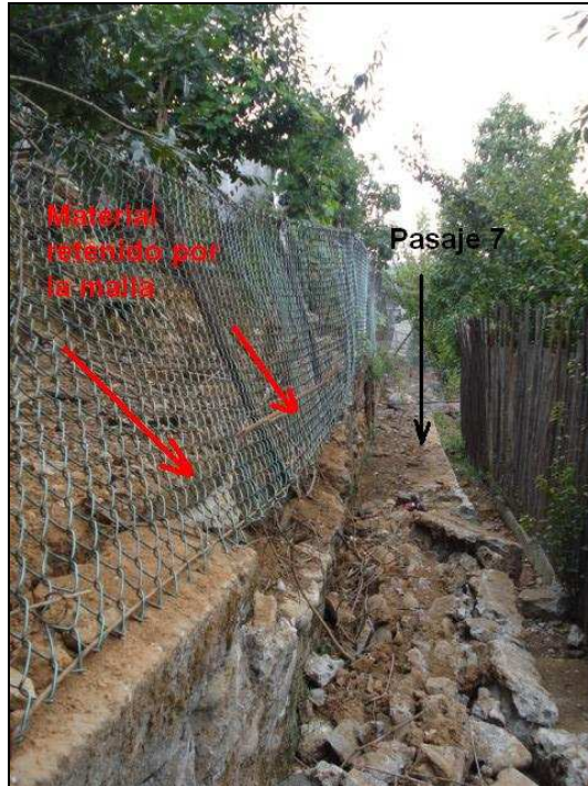
Figura 2: Muestra inestabilidad en ladera generada por asentamiento del terreno en el pasaje 7. Se observa como la malla metálica contuvo gran cantidad de material removido desde la aldera.
