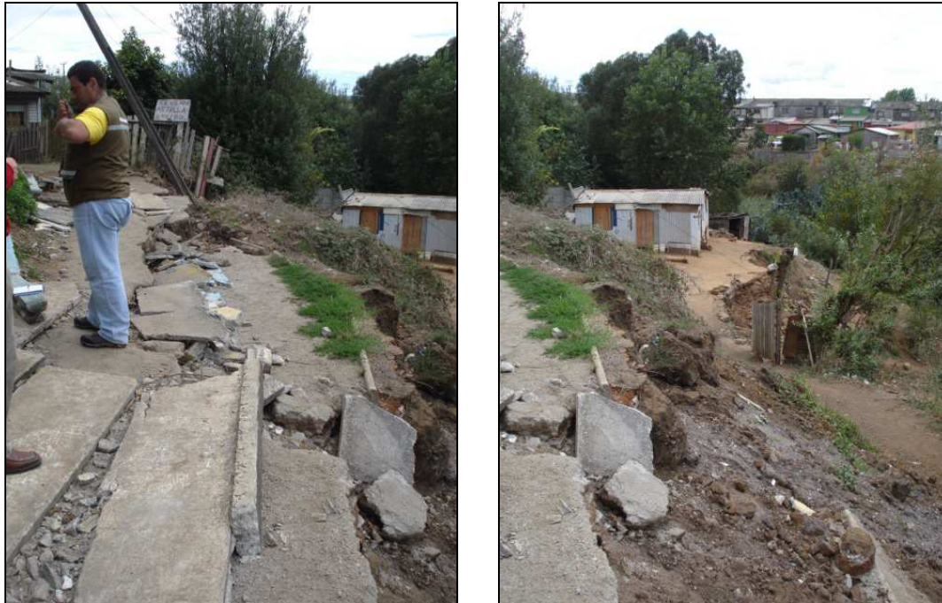
Figura 12. Grietas, hundimientos y deslizamientos de suelo en el sector de Villa La Ilusión.
