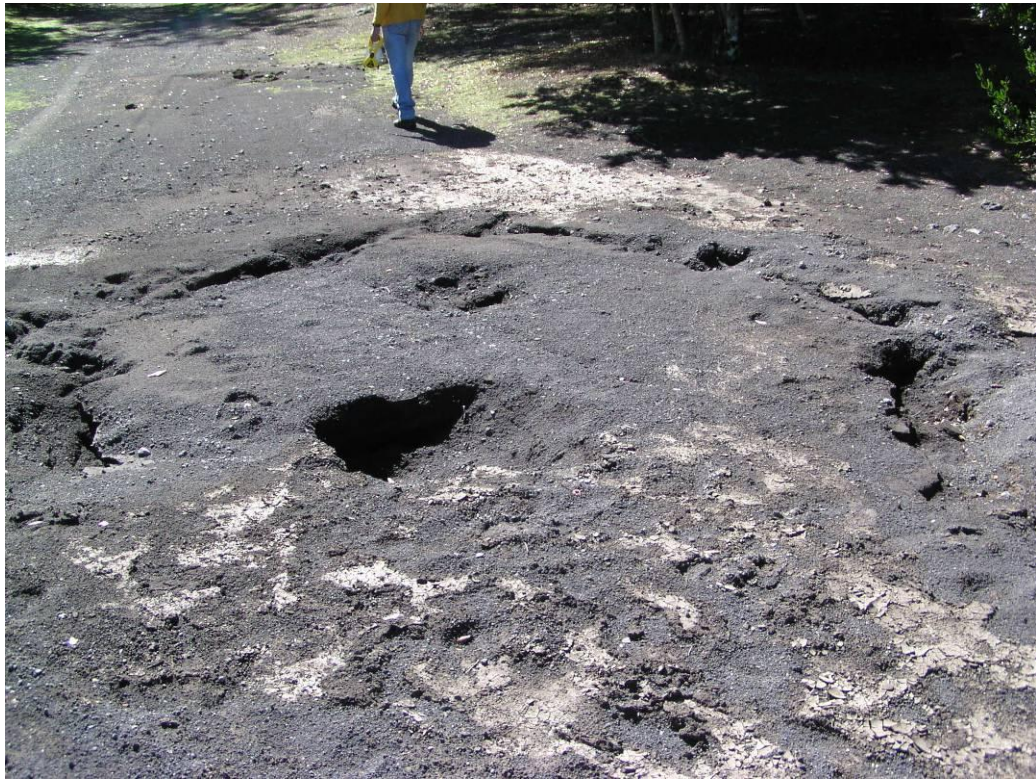
Foto 9. Acumulación de sedimentos finos (arcillas y limos de color gris blanco) por flujo de agua freática hacia la superficie (licuefacción).
