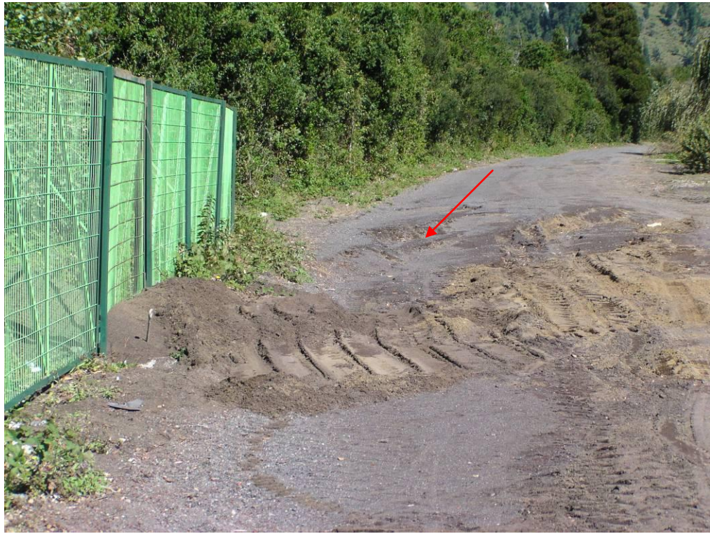
Foto 15. Hundimiento del terreno y grietas, en color rojo, en sector costanera de Coñaripe.
