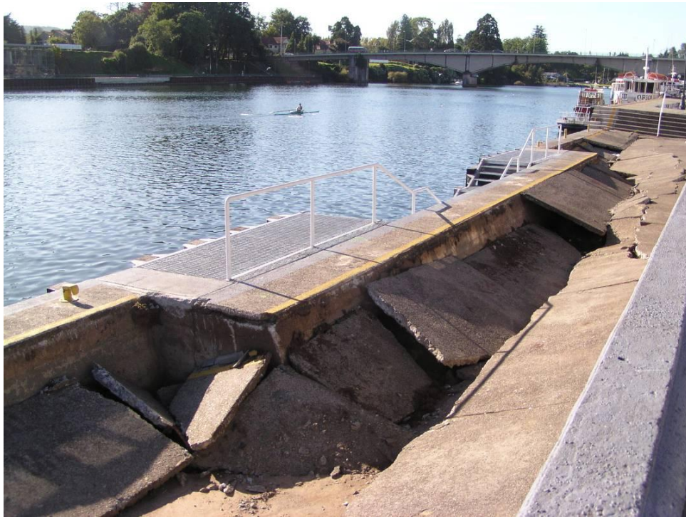
Foto 6. Muelle Schuster, Valdivia. Colapso de losas peatonales asociados a licuefacción del terreno.
