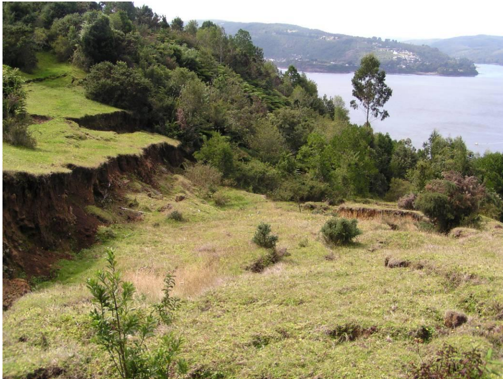
Foto 4. Grietas escalonadas y deslizamiento multirotacional en sector alto de Caleta Amargos.
