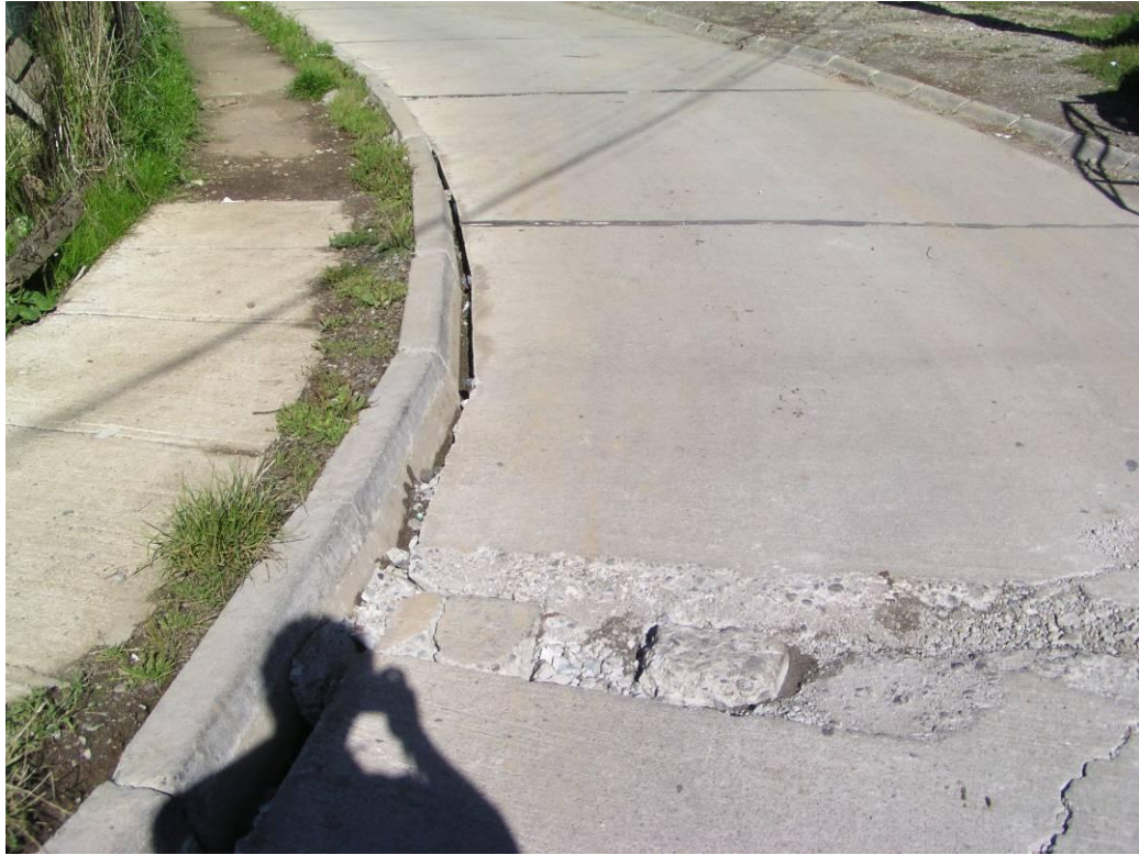
Foto 5. Grietas (licuefacción?) que afectan a pavimento en sector Beneficencia, Valdivia.
