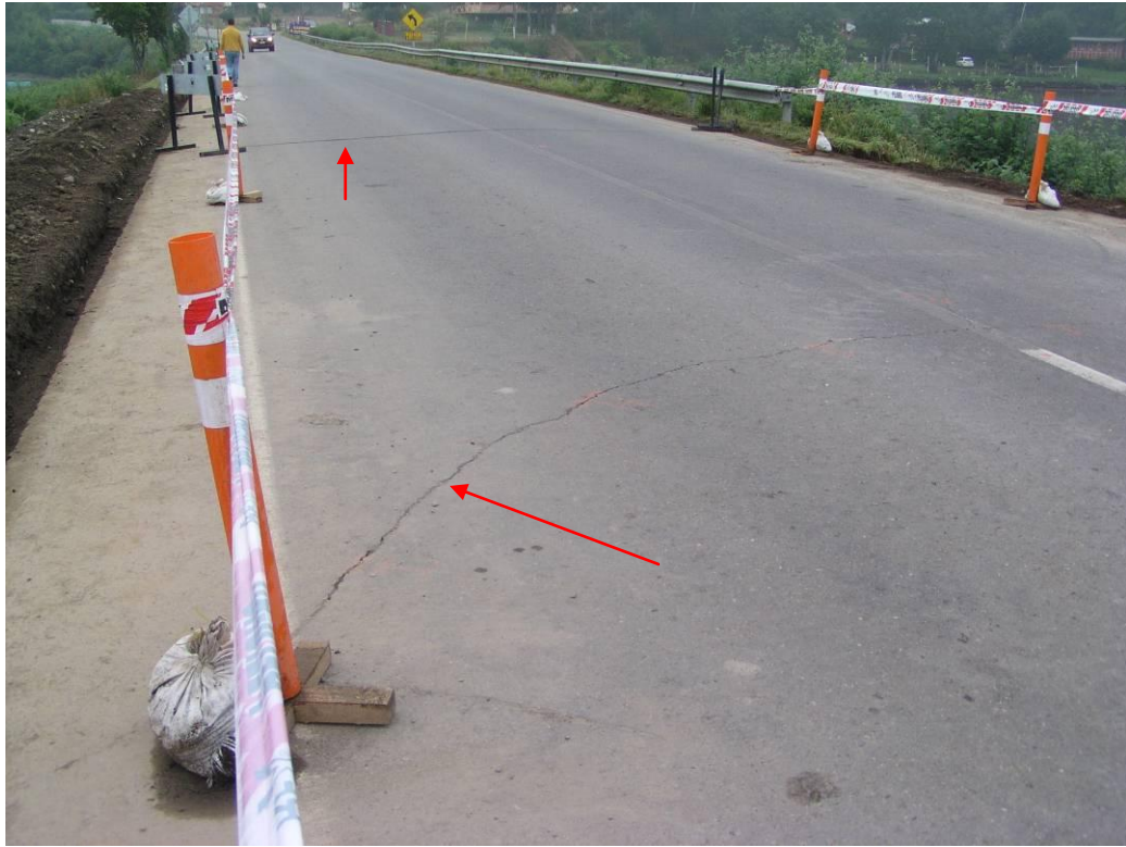
Foto 7. Sector Puente Cutipay, Valdivia-Niebla. Agrietamientos de la calzada indicados con flechas en rojo.
