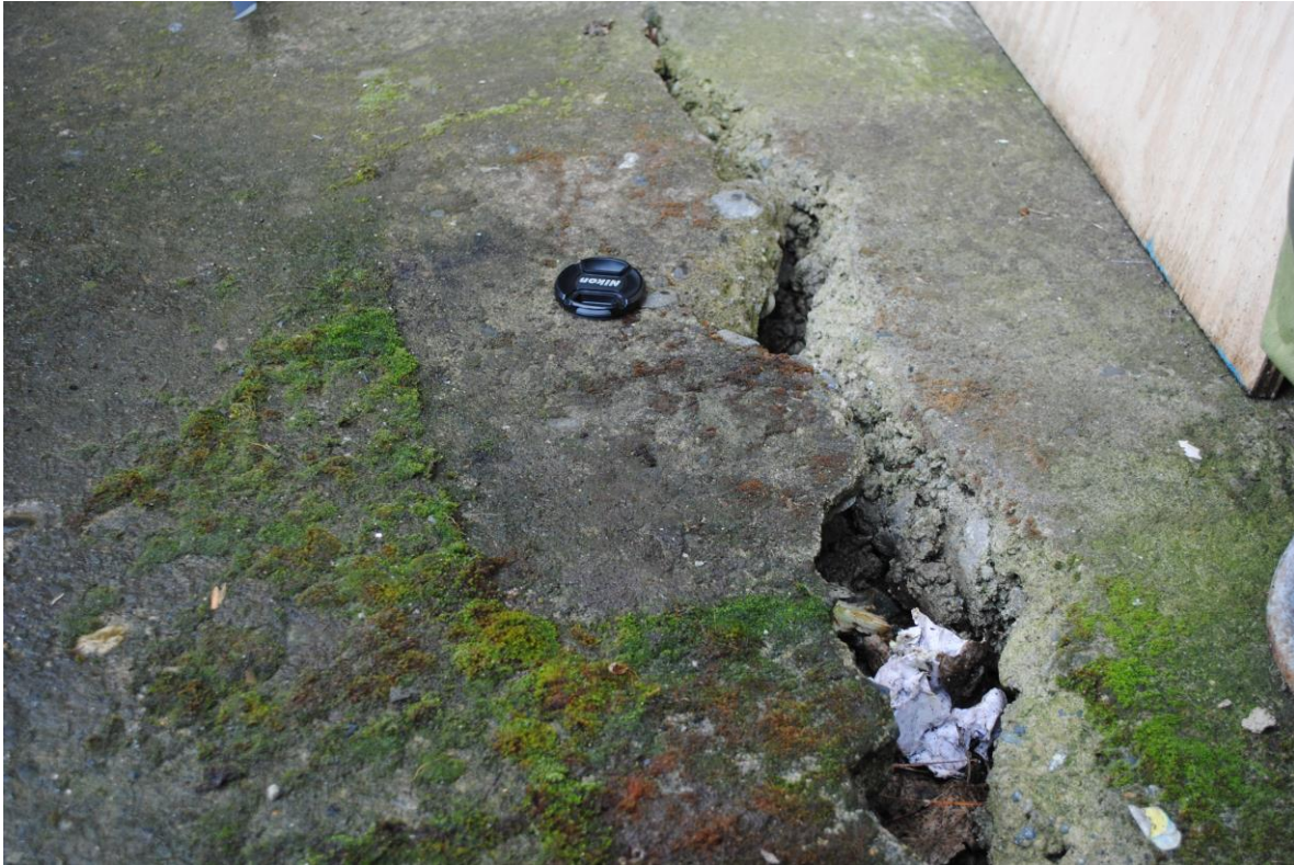
Figura 8. Fotografía de fractura con abertura centimétrica en 'radier' de la parte posterior de la vivienda de calle Central 35B.
