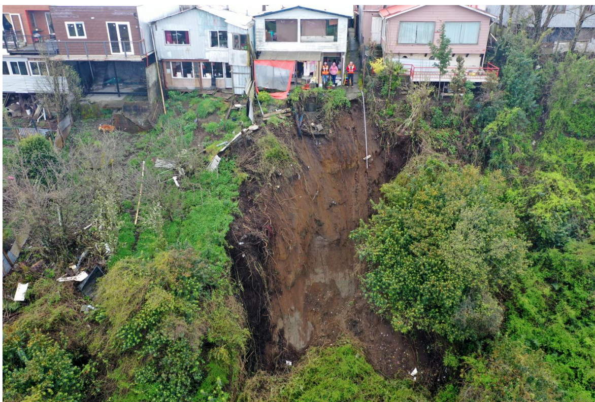
Figura 7. Imagen Dron que muestra superficie de deslizamiento (escarpe) inmediatamente en la parte posterior de las viviendas del pasaje Central consignadas con los números 35A y 35B.
