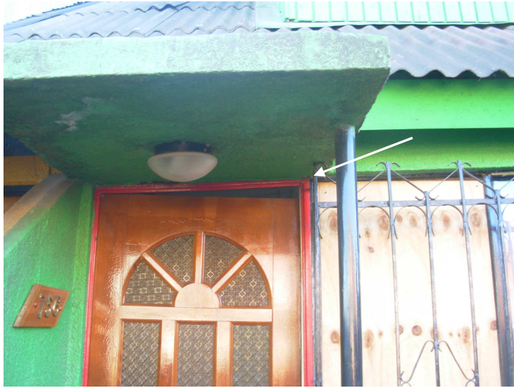
Figura 2: Se observa descuadre de 4 cm entre la puerta y el marco Pje. San Salvador N°756.
