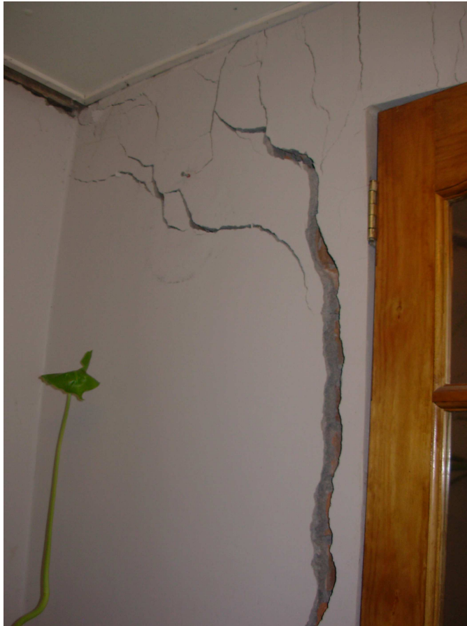
Figura 4: Muestra agrietamiento en muros.
