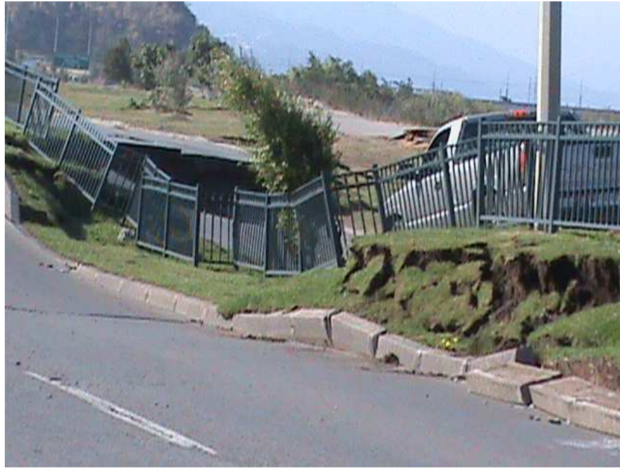
Figura 6: Otra vista de asentamientos y agrietamiento de Av. Costanera.
