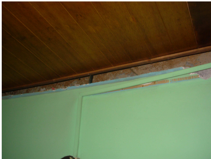
Figura 3: Se observa asentamiento de muros. El muro bajo 9 cms. Pje. San Salvador N°756.
