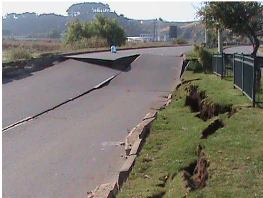
Figura 5: Muestra grieta y asentamiento en Av. Costanera, cerca de las poblaciones afectadas por licuefacción.
