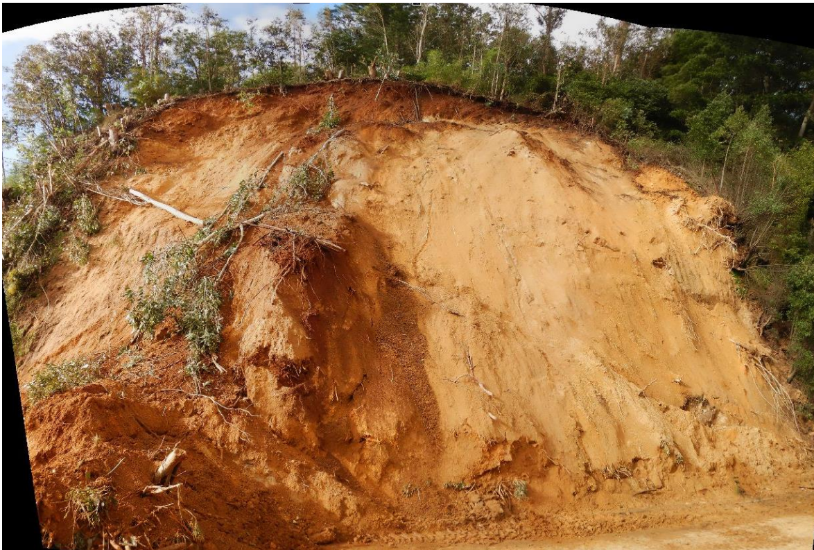
Fig. 9. Panorámica del sector afectado
