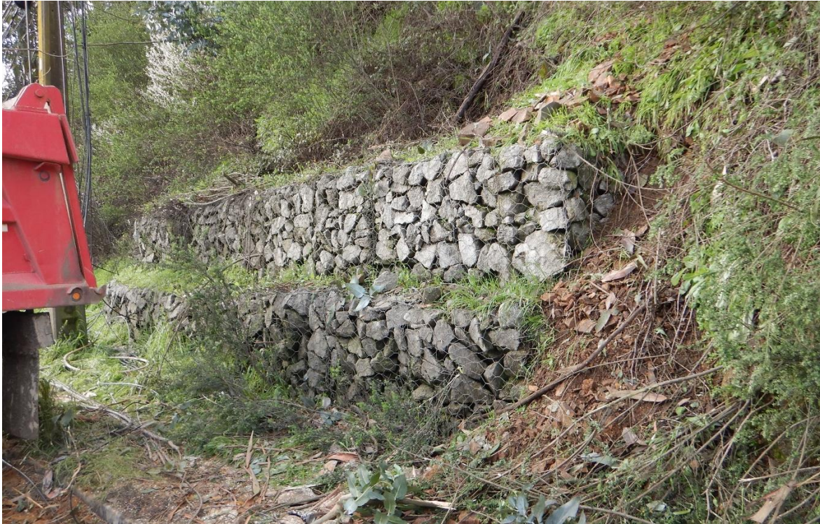
Fig. 10. Medidas de mitigación dispuestas en sectores cercanos al lugar de generación del deslizamiento de suelo.
