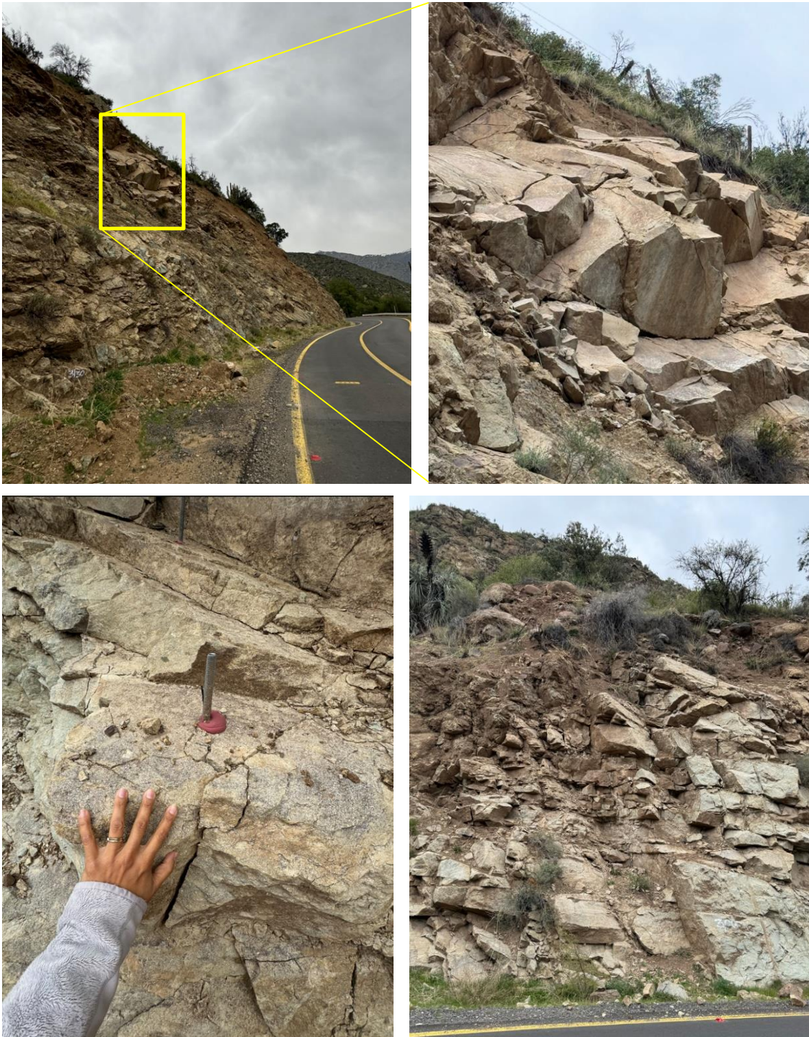
Figura 4. Taludes con afloramiento rocoso de la Fm. Abanico. Se destaca sector altamente fracturado con bloques sueltos (arriba)
