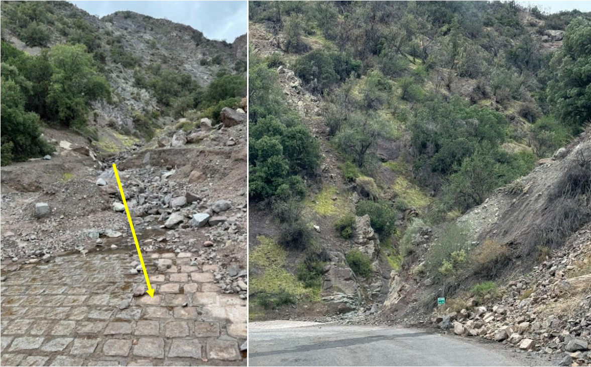
Figura 6. Intersección de ruta G-345 con Quebrada Seca, kilómetro 8. Flecha amarilla indica obra de arte tipo 'badén'.
