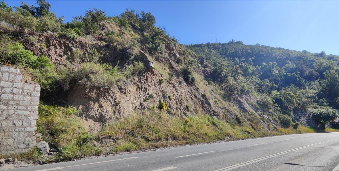
Figura 12. Talud cortando depósitos coluviales y afloramiento rocoso entre los dos muros de contención. Se observan grandes bloques rocosos 'colgando' del talud, susceptibles de caer en el futuro próximo.
