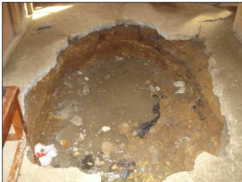
Figura 2. Orificio producto del colapso de un pique al interior de una vivienda en calle Jericó, villa Monte Los Olivos.
