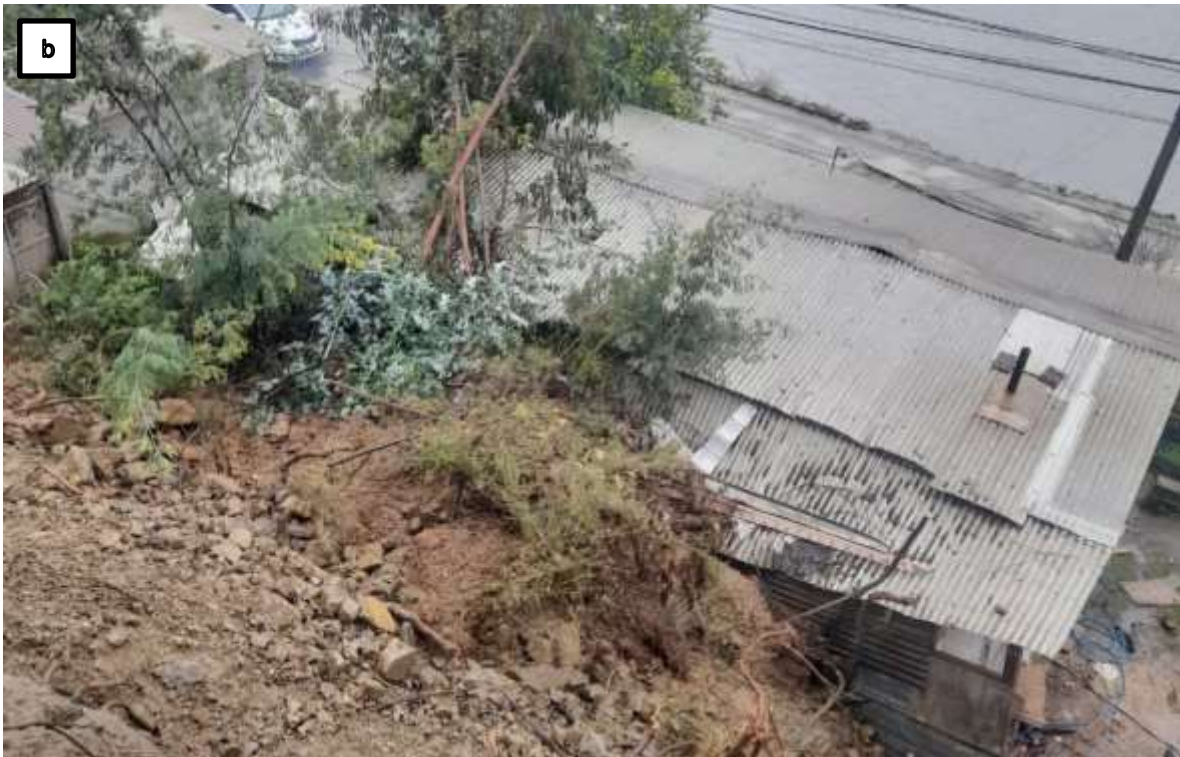
Fig. 5. Viviendas afectadas por el deslizamiento. a. Vista general desde la calle José Manuel Balmaceda, donde se aprecia la cicatriz del deslizamiento. Nótese la pared volcada en la parte trasera de la vivienda de la derecha. b. Vista desde la ladera, sobre el deslizamiento. Se aprecia el depósito de la remoción en masa generado, que consiste en rocas, suelo y vegetación, incluyendo árboles cercanos a los 5 metros de altura.
