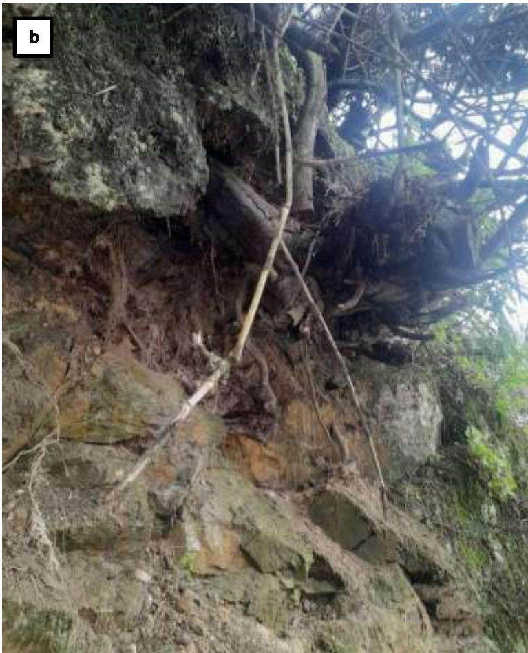
Fig. 6. Detalle de cicatriz del deslizamiento. a. Vista lateral de la parte superior del deslizamiento. Se aprecian sectores con afloramientos de esquistos, con estructuras de alta pendiente ( \sim 90^\circ , en rojo), mientras que los depósitos resultantes del suelo movilizado poseen pendientes cercanas a 40^\circ (azul). b. Sector al SO del punto principal del desprendimiento de material, que se aprecia inestable, consistente en la litología identificada, con un gran fracturamiento debido a la presencia de raíces.
