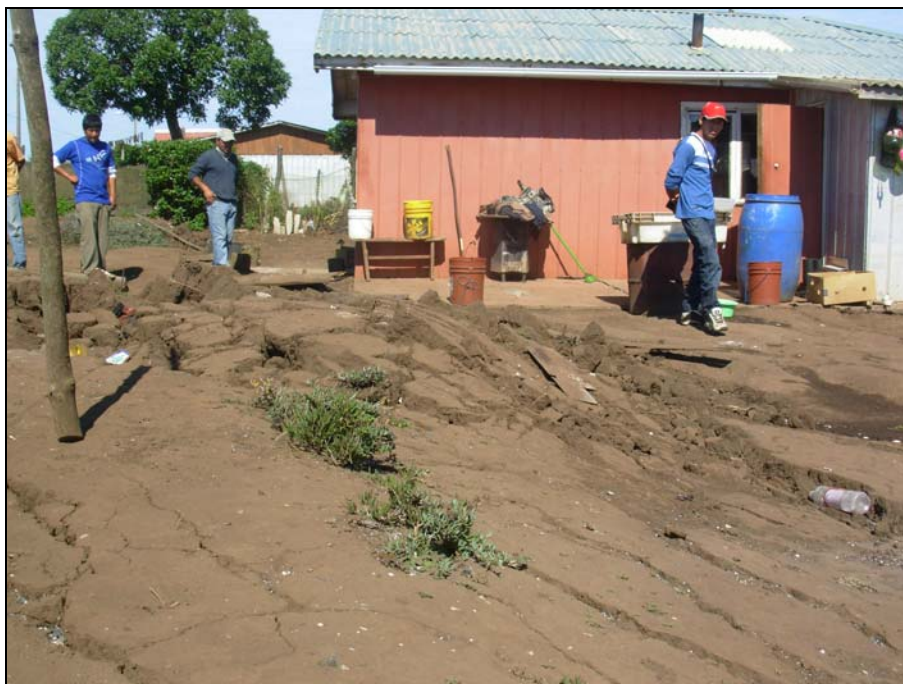
Fig 2: Sector Caleta Hernández. Terrenos fuertemente fracturados por el agrietamiento, afectan con daños de diversa consideración a las viviendas cercanas.
