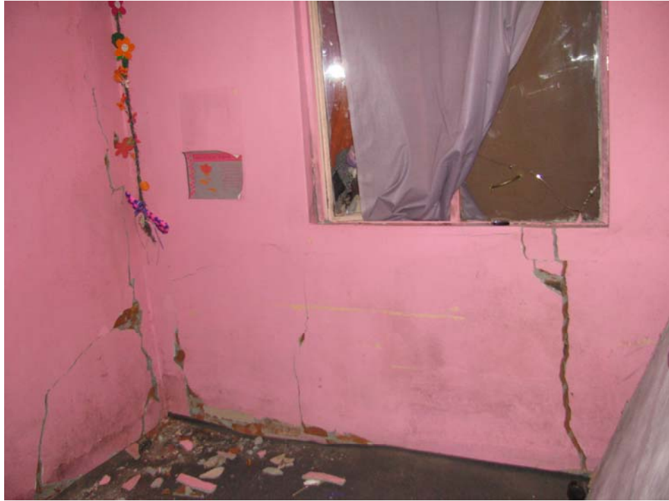
Fig.9: Arauco, Villa Juan Pablo II. Se observa destrucción en viviendas.
