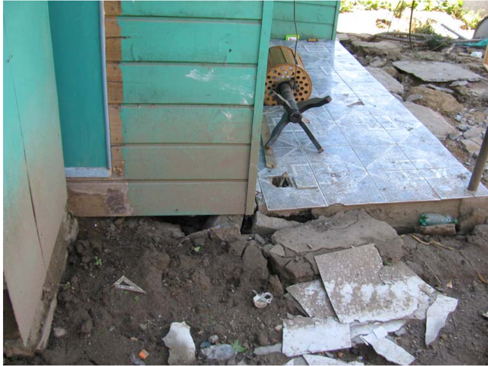
Fig.5 Arauco, Población 12 de abril. Vivienda desplazada y destruida por grietas asociadas al deslizamiento.
