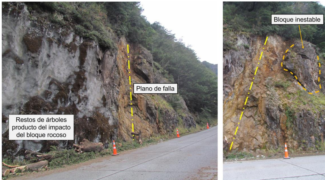
FIG. 5. Plano de falla identificado en terreno con bloque rocoso inestable.
