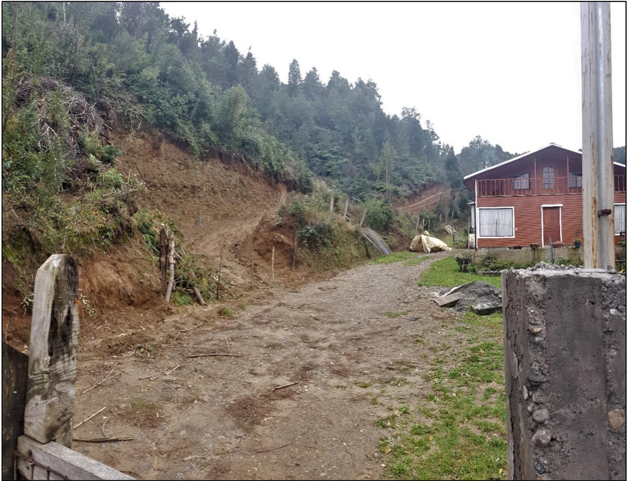
FIG. 5. Vista general hacia el talud que bordea el camino de acceso al loteo.
