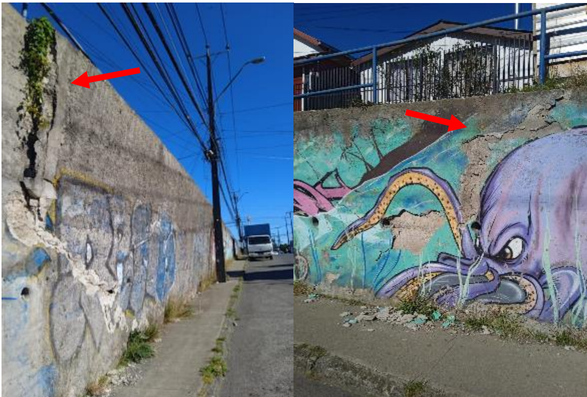
Figura 3. Fotografía del muro de contención previo al evento del día 24 de marzo, donde se observa a la izquierda la grieta y a la derecha la fractura en el muro de contención.
