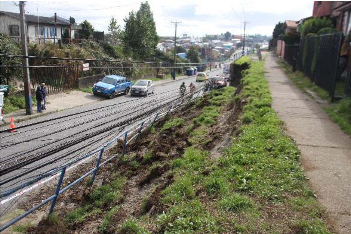
Figura 6. Fotografía de la zona posterior del deslizamiento y vereda. No se observan grietas en esta zona.
