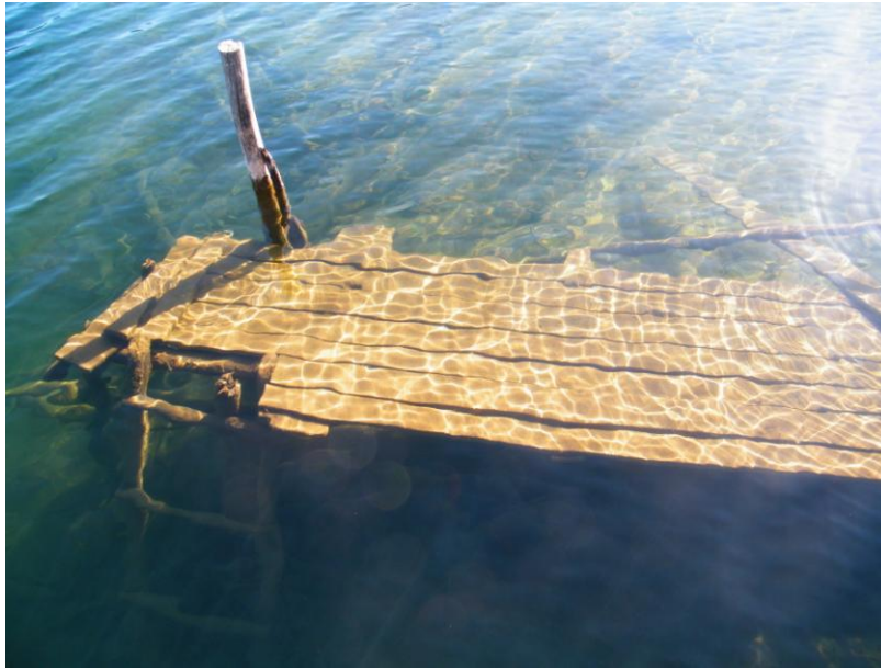
Fig. 7 Huillinco. Muelle paralelo al principal, completamente sumergido por la elevación de 0,50 m del nivel del agua del lago Lleulleu.
