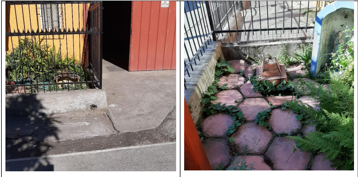
FIG. 7. Daños provocados por hundimiento del terreno, en acceso y jardines de la casa 2809 del pasaje 5. Izquierda. Grietas y hundimiento del terreno en el acceso a la casa. Derecha. Hundimiento diferencial de baldosas en el jardín.
