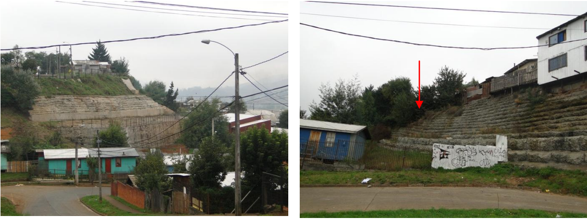
Figura 1. Vista desde los dos extremos de la ladera donde se observa el muro de contención que no se extiende en toda su extensión. Flecha indica donde termina el muro (Casa 0625).
