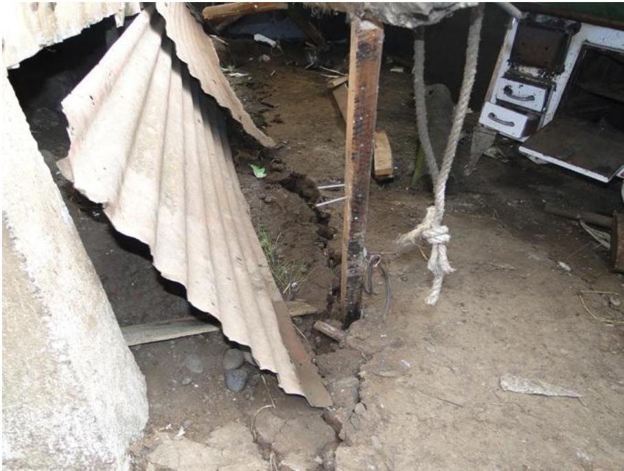
Figura 2. Grietas en el patio trasero de vivienda con desplazamiento horizontal y aperturas de 15 cm.
