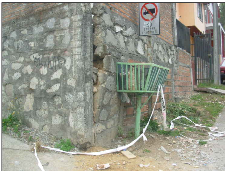
Figura 5: Muro agrietado y colapsado hacia paso peatonal de pasaje Los Abetos, con peligro inminente de caída, es necesaria su demolición.
