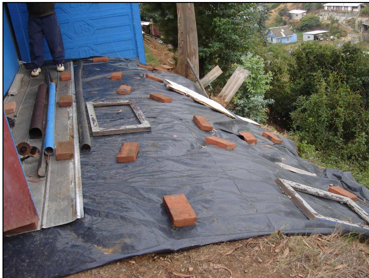
Figura 2: Muestra situación de los patios de viviendas ubicadas en Pje. El Espino, donde las remociones en masa hicieron colapsar parte del terreno y dejaron inestable la ladera. Se observa plástico cubriendo las grietas existentes inmediatamente al lado de las viviendas, de más de 1 m de profundidad y que podrían ser planos de despegue de nuevas remociones.
