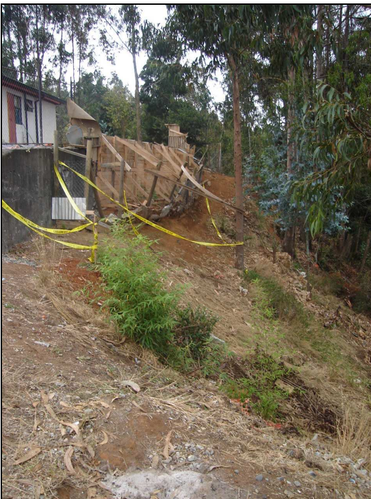
Figura 4: Área verde con peligro de colapso y remoción en masa hacia viviendas de pasaje Los Avellanos, en este caso la casa que se observa en el extremo superior izquierdo de la fotografía, también se encuentra en situación de peligro de colapso. Se deben diseñar e implementar en forma urgente obras de estabilización para asegurar las viviendas que se encuentran tanto en la parte superior como en el pie del talud.
