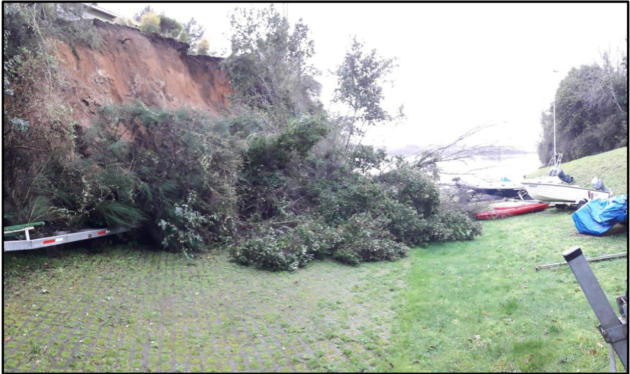
FIG. 4. Fotografía de la remoción en masa, en forma previa a que se realizaran los trabajos de despeje. Se observa la gran cantidad de cobertura vegetal que fue desplazada por la remoción, la cual afectó directamente un carro de arrastre estacionado en la base del talud. Fotografía tomada por un vecino del sector.
