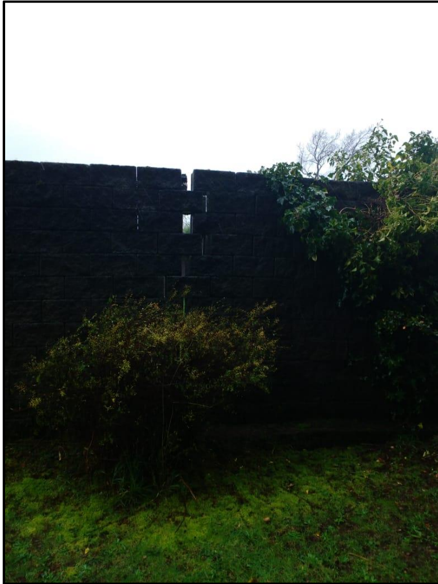
FIG. 7. Fotografía de la parte superior de la terraza, en el límite sur de la terraza que limita directamente con el río Valdivia. Se observa una grieta en el muro de la propiedad privada, lo que indica la existencia de un desplazamiento del talud. Esto constituye una situación de inestabilidad en este borde de la terraza.
