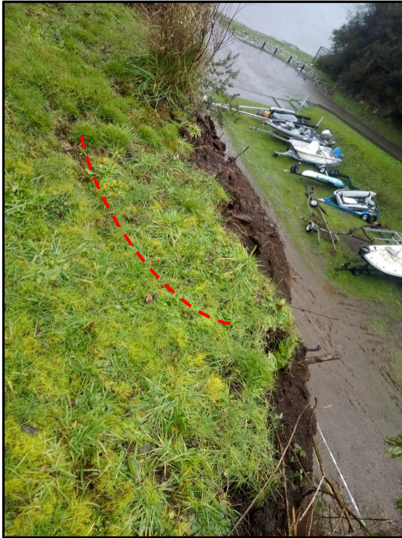
FIG. 6. Fotografía de la parte superior de la terraza afectada. A 30 cm del borde del talud, se observan grietas métricas sub-paralelas al borde de la terraza. La línea roja se utiliza como referencia de la traza de la grieta principal. Lo anterior indica que, en la corona de la emoción en masa (parte superior de la terraza) aún existe un volumen de material en condiciones inestables.
