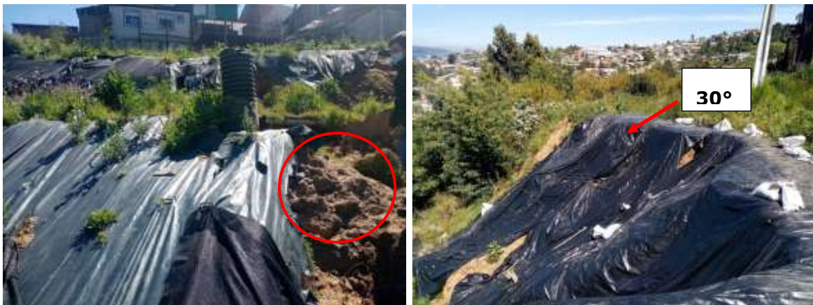
FIG. 3. Izq. Estado de la membrana impermeable que cubre el talud deslizado. En círculo rojo se observan material suelto en el talud sin recubrimiento del nylon. Der. Ángulo medido del talud 30°, vista hacia el suroeste.
