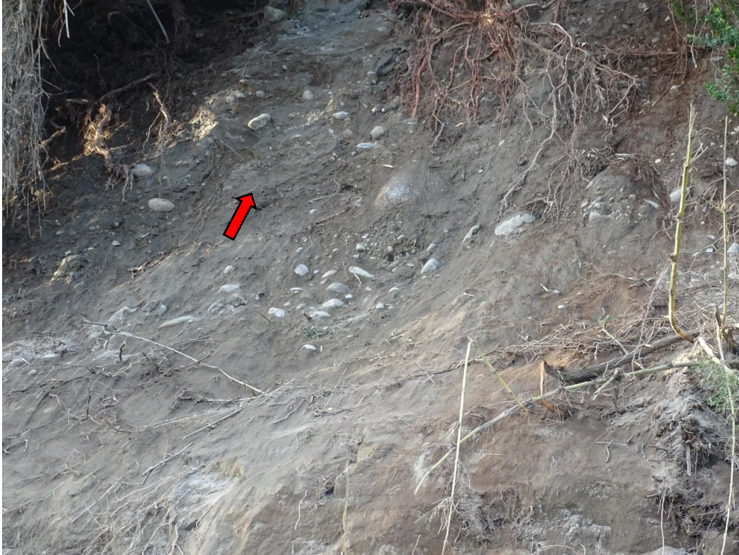
Figura 2. Fotografía de la parte alta de la ladera. Se observan gravas y arenas no estratificadas, correspondientes a depósito de till.
