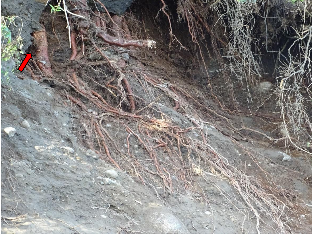
Figura 4. Fotografía de la parte alta de la ladera. Se observan raíces de árboles que, debido a su crecimiento, generan grietas en el depósito semi-consolidado de origen glacial (till).
