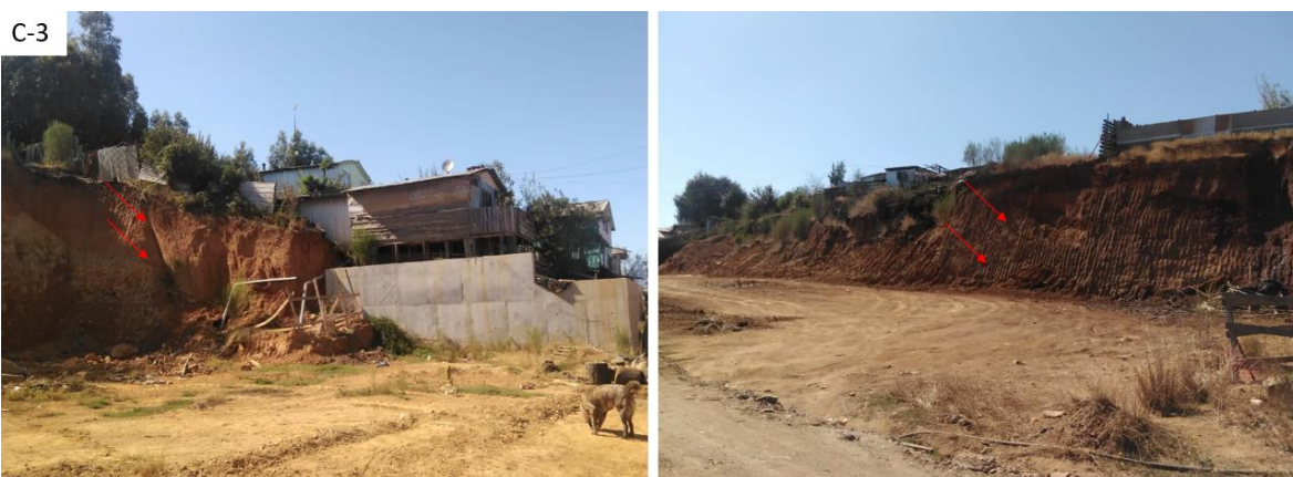
Fig. 6. Sector C-3. Izq. Zona de caída de bloques, perteneciente a la Fm. Curanilahue, correspondiente a areniscas pardas con niveles de carbón. Der. Zona de deslizamientos locales en el talud de materiales no consolidados, el ángulo del talud es subvertical.
