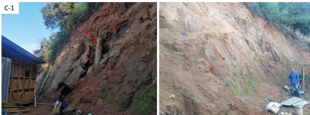
Fig. 4. Sector C-1. Izq. Zona de caída de rocas, perteneciente a la Fm. Curanilahue, correspondiente a areniscas pardas con niveles de carbón. Der. Zona de deslizamientos locales en el talud de materiales no consolidados.
