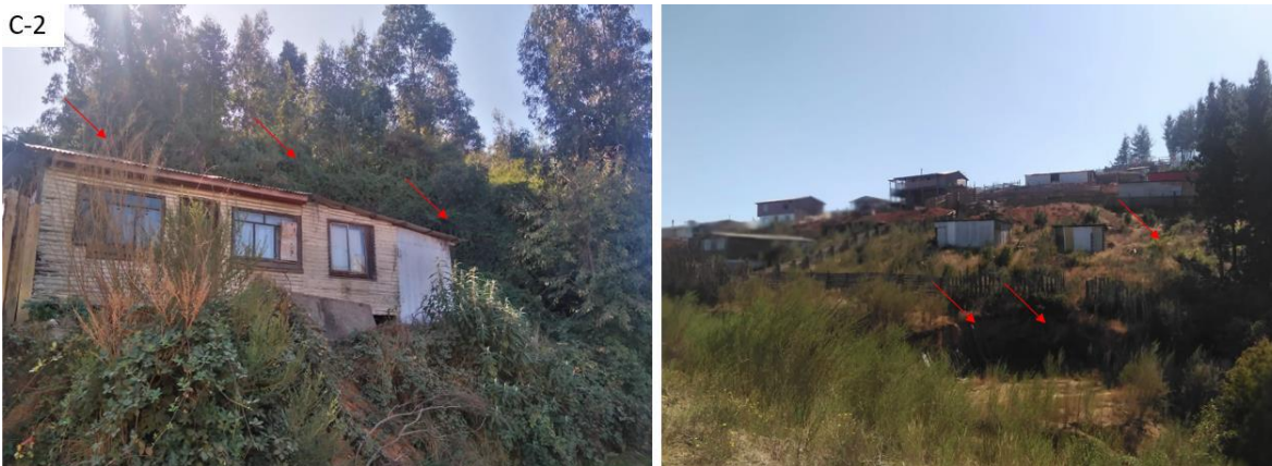
Fig. 5. Sector C-2. Izq. vivienda desalojada por problemática de caídas de roca en la población. Der. Zona de retroceso del talud que presenta remociones en masa locales en el talud subvertical.
